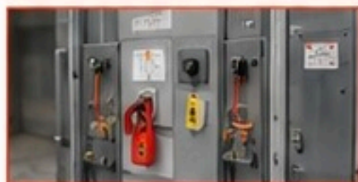
Mise hors tension et consignation
