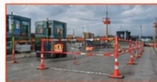
Chantier et zones à risque
